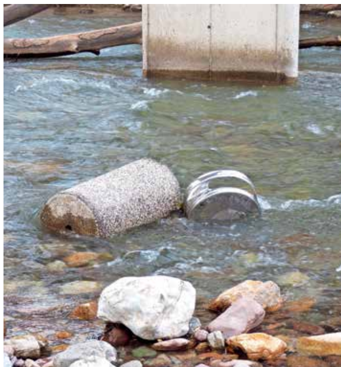
Betonski smetnjak v Sori pod Neškovo brvjo je bil žrtev vandalizma. FOTO: JURE FERLAN
